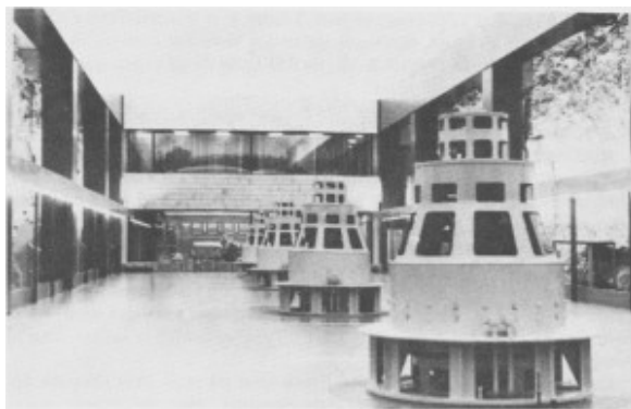
4 aggregater på plass i Nea kraftverk.
